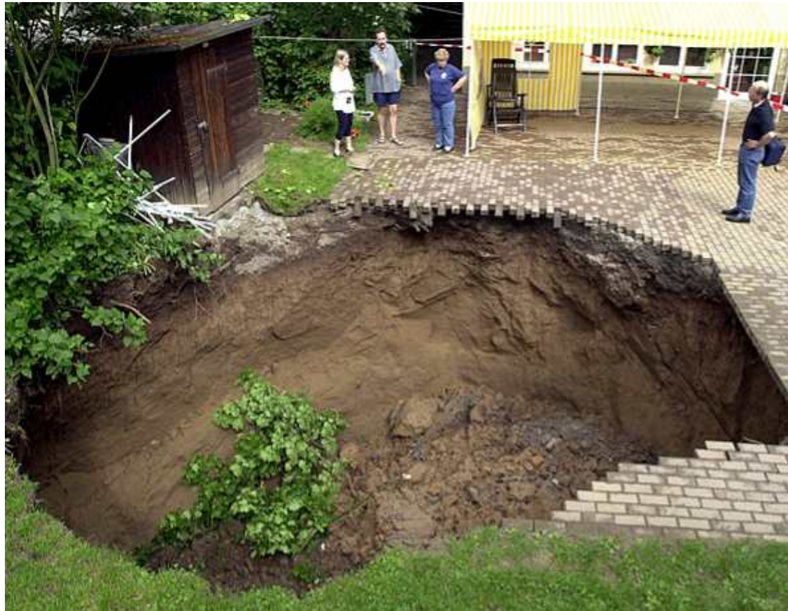
Einsturztrichter (Dolinen) und Hohlräume in Bad Cannstatt
